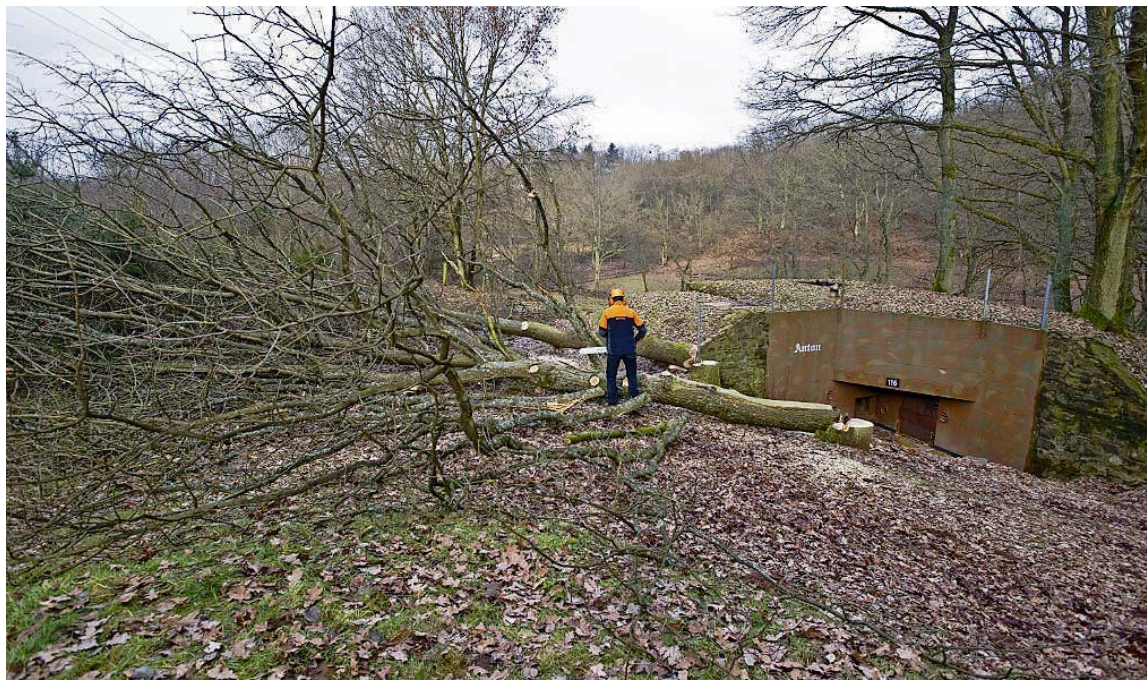
Bereits erfolgt: Rodungsarbeiten für den Bau der Ortsumgehung Besseringen. Foto: Rolf Ruppenthal
